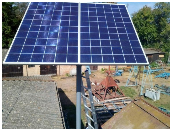
Рис. 1. Фотоелектричні панелі на двохосьовому трекері.
