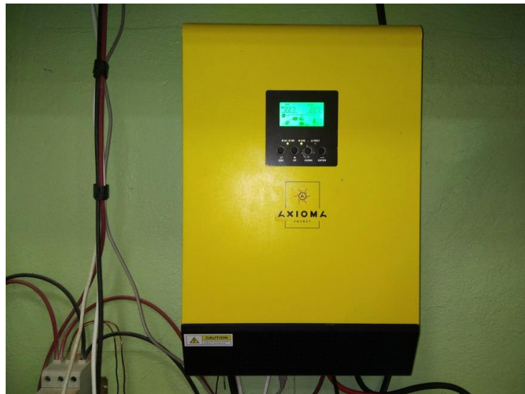
Рис. 2. Гібридний інвертор Ахіота, до якого підключені блок фотоелектричних панелей, електромережа і акумуляторні батареї.
